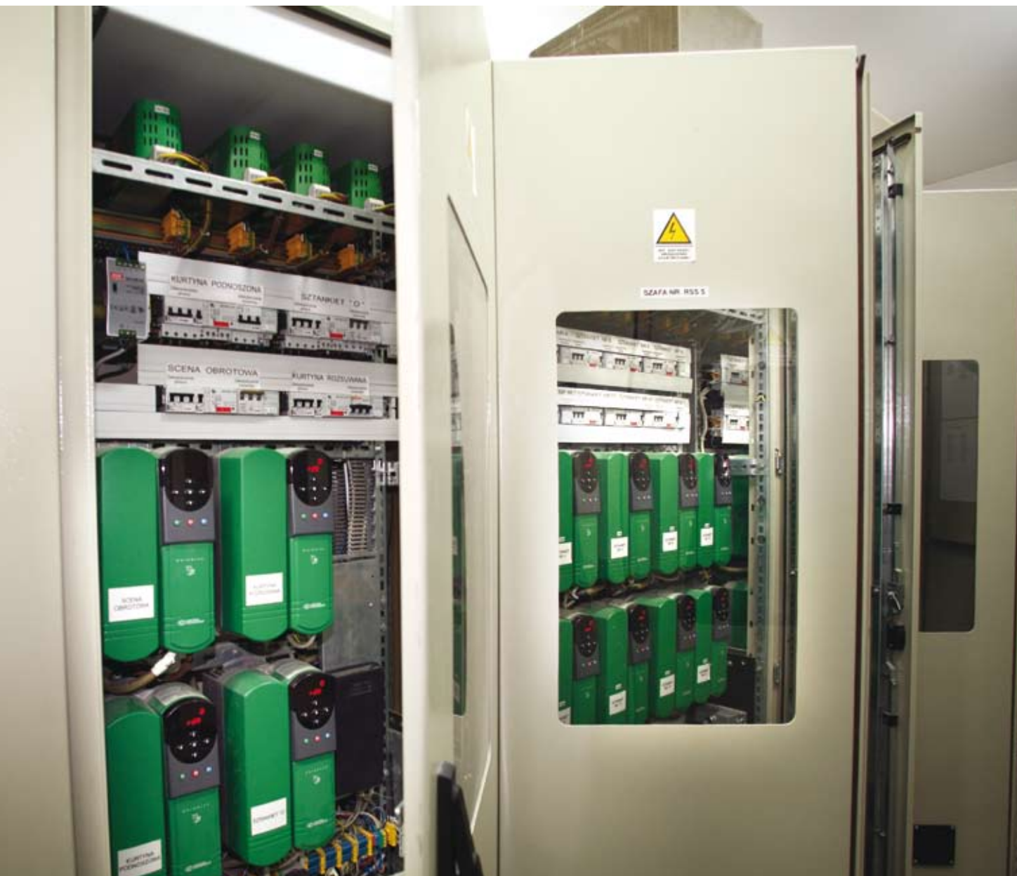
Zdjęcie 43. Rozdzielnia napędów. Opera Wrocławska. Projekt i wykonanie: Przedsiębiorstwo Specjalistyczne TEATR. 2001
