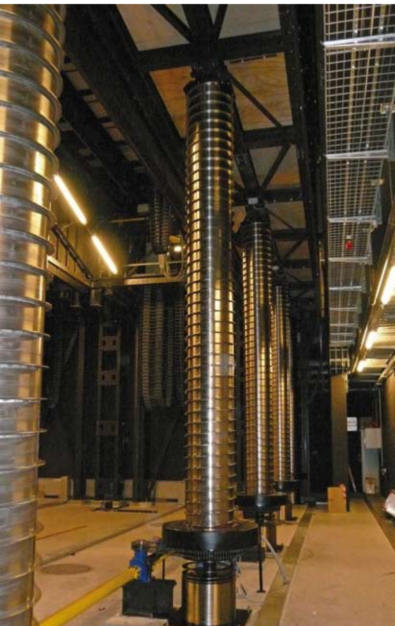
Zdjęcie 36. Zapadnia z napędem spiralift. Opera w Kopenhadze. Wykonawca Waagner Biro (Austria). 2004
