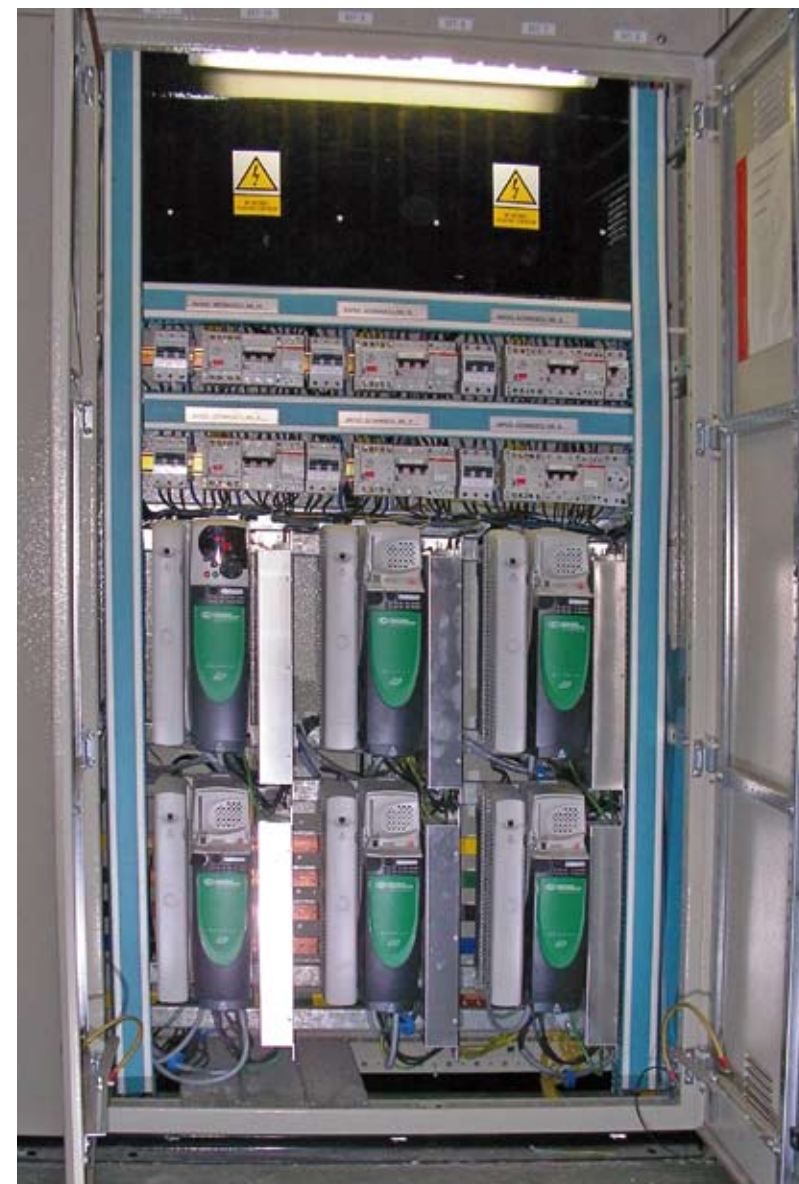
Zdjęcie 42. Rozdzielnia napędów elektrycznych sceny. Opera Nova w Bydgoszczy. Projekt: Tomasz Zaborowski. 2001
