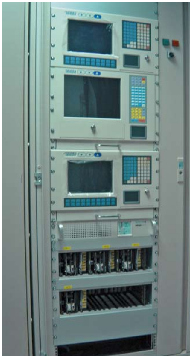
Zdjęcie 41. Rozdzielnia napędów, pole automatyki – Opera Nova w Bydgoszczy. Autor projektu: Tomasz Zaborowski. Realizacja: Przedsiębiorstwo Specjalistyczne TEATR. 2001
