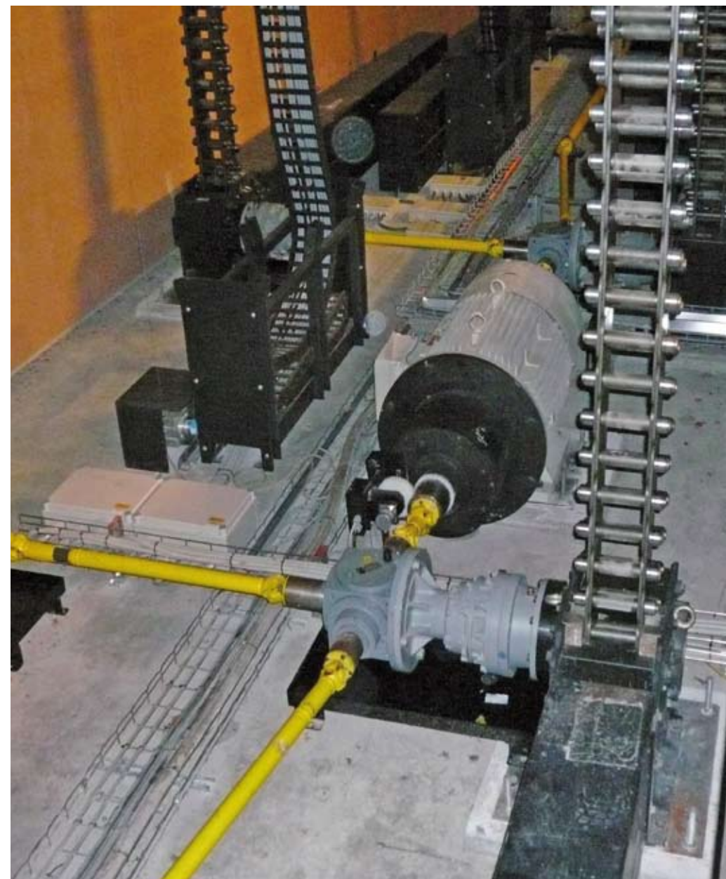
Zdjęcie 35. Zapadnia z napędem łańcuchowym Opera w Kopenhadze. wykonanie: Waagner Biro (Austria). 2004
