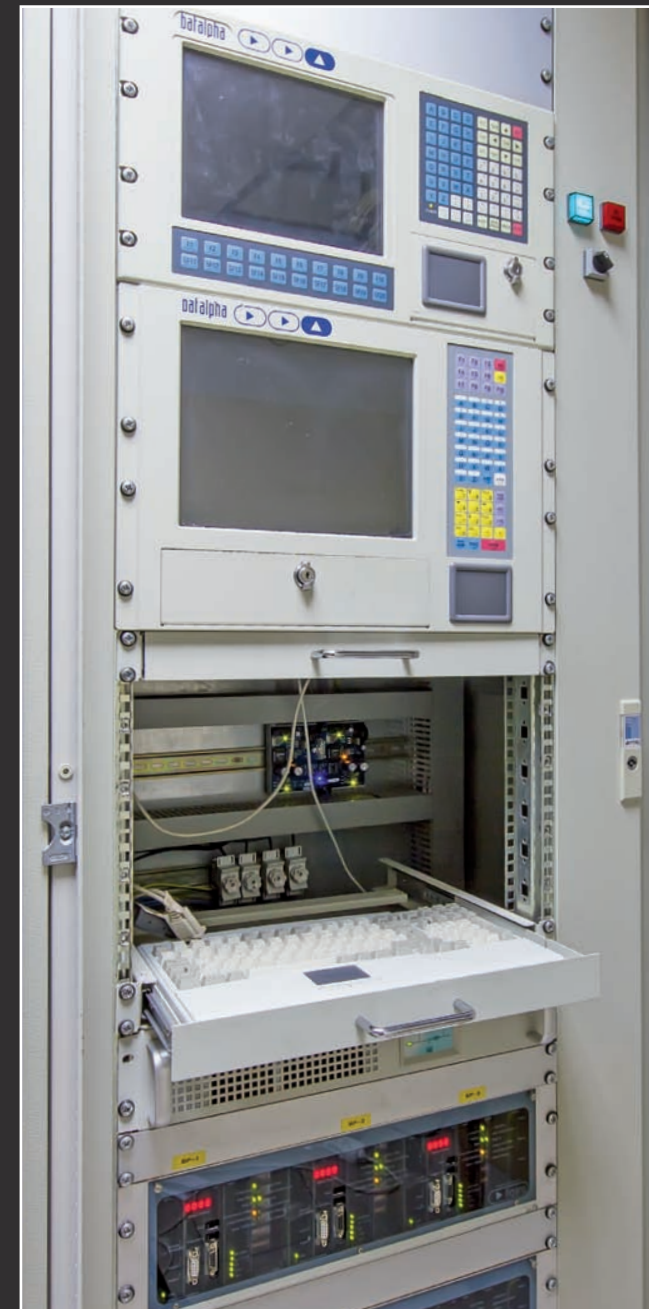
□ ROZDZIELNIA NAPĘDÓW ZAPADNI
