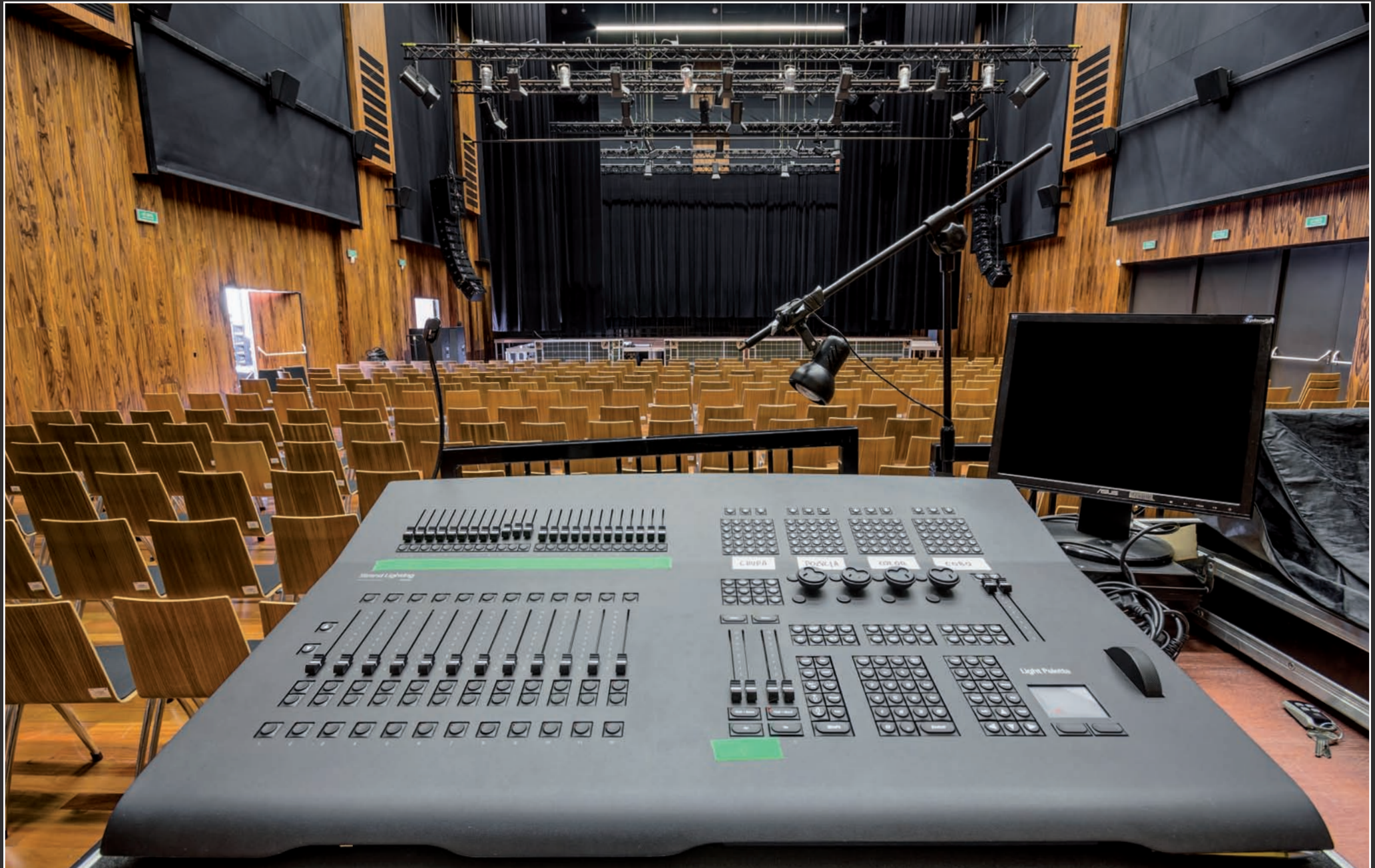
❑ KONSOLETA OŚWIELENIOWA FIRMY PHILIPS STRAND LIGHTING
