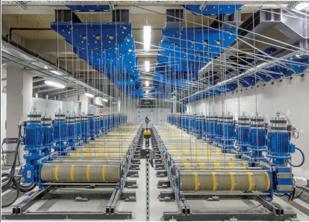
❑ MOTOR ROOM - SALA TEATRALNA
