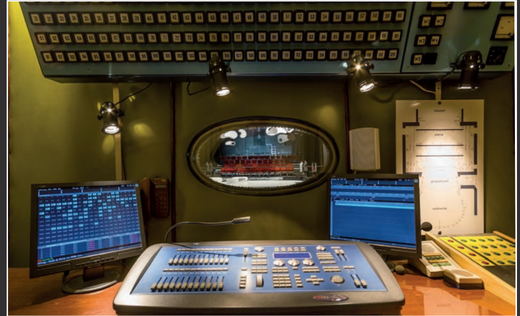
□ POMIESZCZENIE REALIZATORA OŚWIETLLENIA
