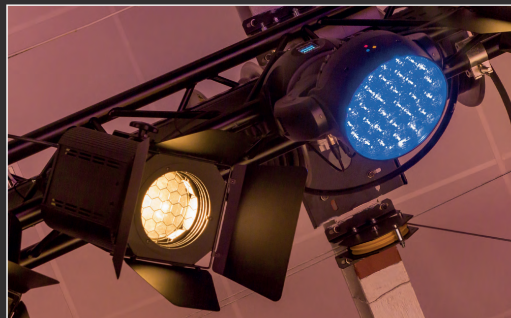
□ OŚWIELENIE TECHNOLOGICZNE FIRMY DTS
