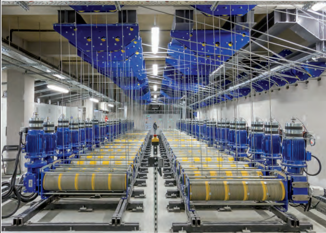
□ MOTOR ROOM - SALA TEATRALNA
