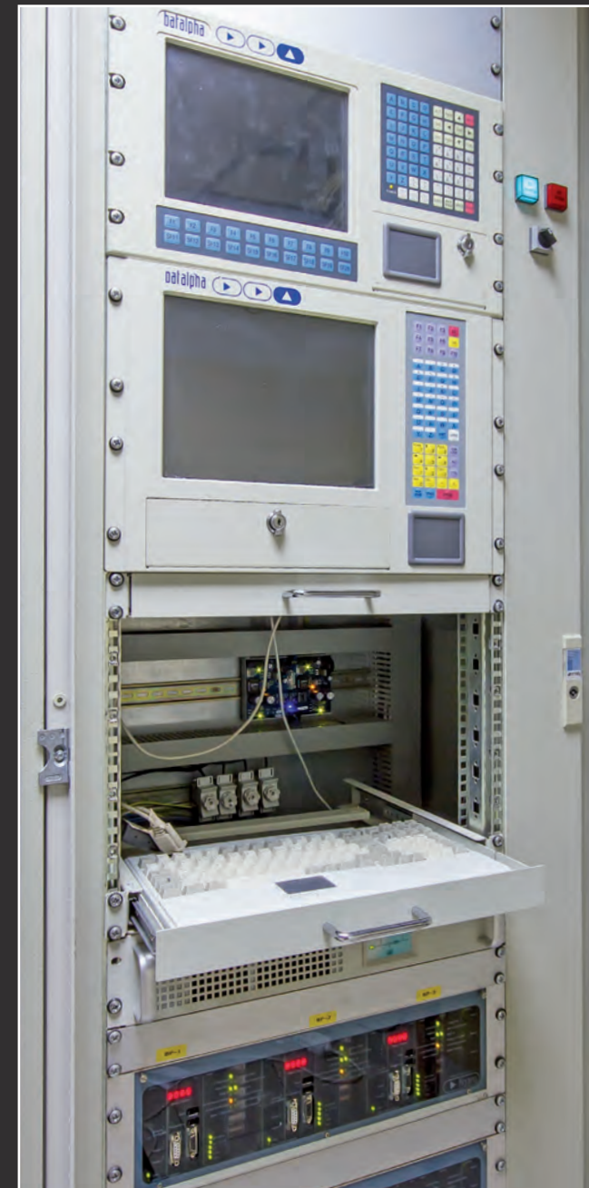
□ ROZDZIELNIA NAPĘDÓW ZAPADNI
