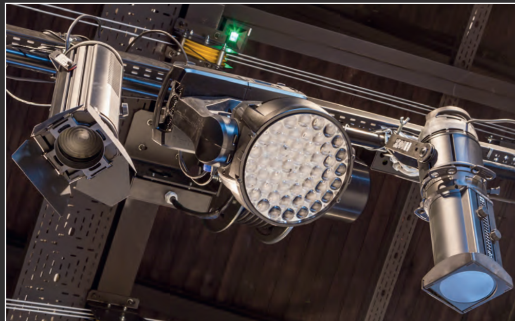
❑ OŚWIETLENIE TECHNOLOGICZNE SCENY
